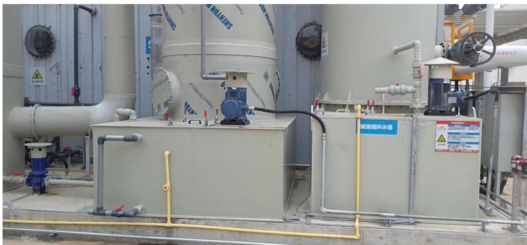
图 10.4-1 碱液循环水箱加盖密封设施
