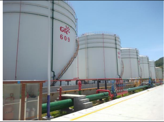
消防管道及罐组围堰
